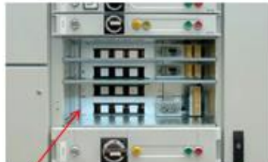
Compartiment pour tiroir comprenant les volets de protection "Broches" + les borniers des contacts auxiliaires "commande".
