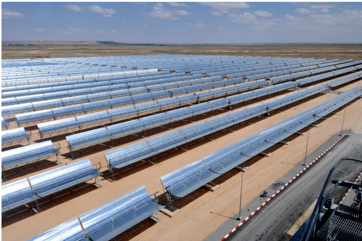
Figure 11.3 : centrale à collecteurs cylindro-paraboliques
