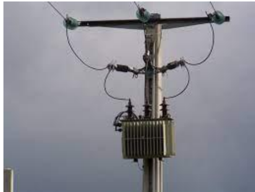
Figure 12.2 : Transformateur haut de poteau
